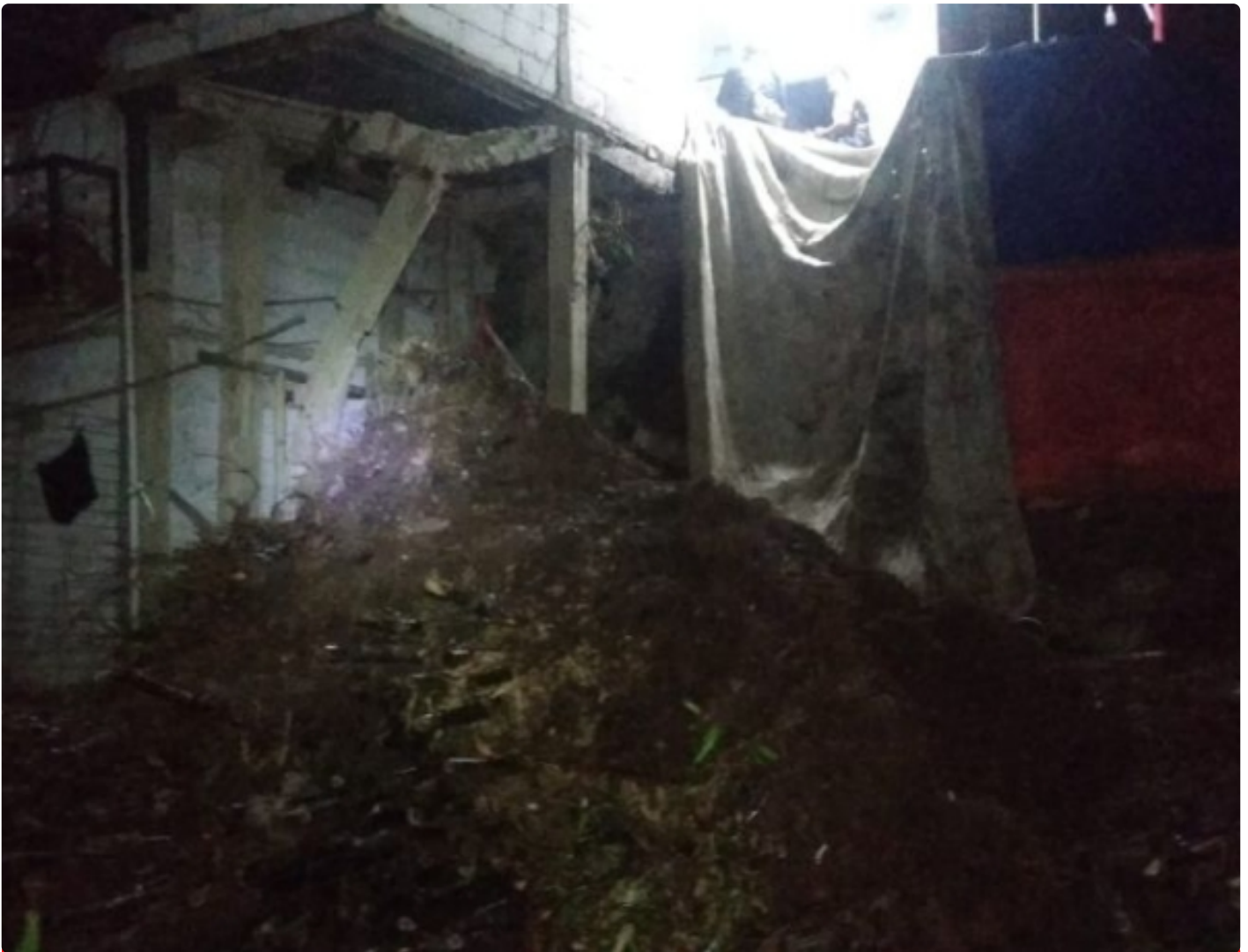
Akibat Hujan Deras, Longsor Terjadi di Wilayah Kecamatan Parungkuda/Dok P2BK Parungkuda
